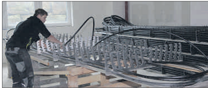
Die Solar-Luftabsorber werden hier gerade in Rahmen gelegt. Die Röhren sammeln Wärme aus der Umgebungsluft und werden auf einem der Flachdächer der früheren Industriehallen rund zwei Meter hoch aufgestapelt. (Fotos: Schmitz)
