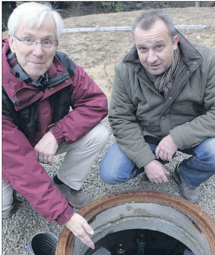
Nach dem Bau ist nur noch eine Revisionsluke zu sehen. Dietmar Brück und Horst Hüttmann zeigen den Einstieg in den Eis-Energiespeicher, der das gesamte Areal in Zukunft mit Wärme versorgen wird.
