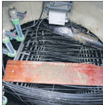
Blick in den Eisspeicher. Sieben Meter geht es nach unten, zu sehen sind die Wärmetauscher.
